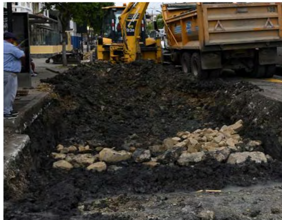
Figura 7. Pobre control de tráfico en zonas de construcción
