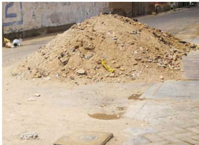
Figura 6. Materiales de construcción en la vía pública que dificulta la circulación.
