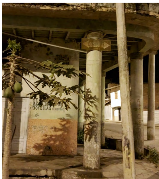
Figura 3. Falta de visibilidad de la señalética por desgaste y por estar ubicada lejos del borde la vía
